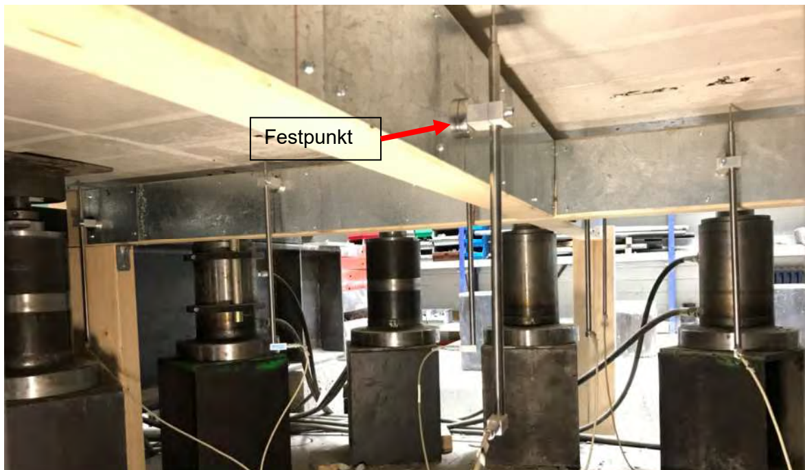
Wegaufnehmer im eingebauten Zustand
