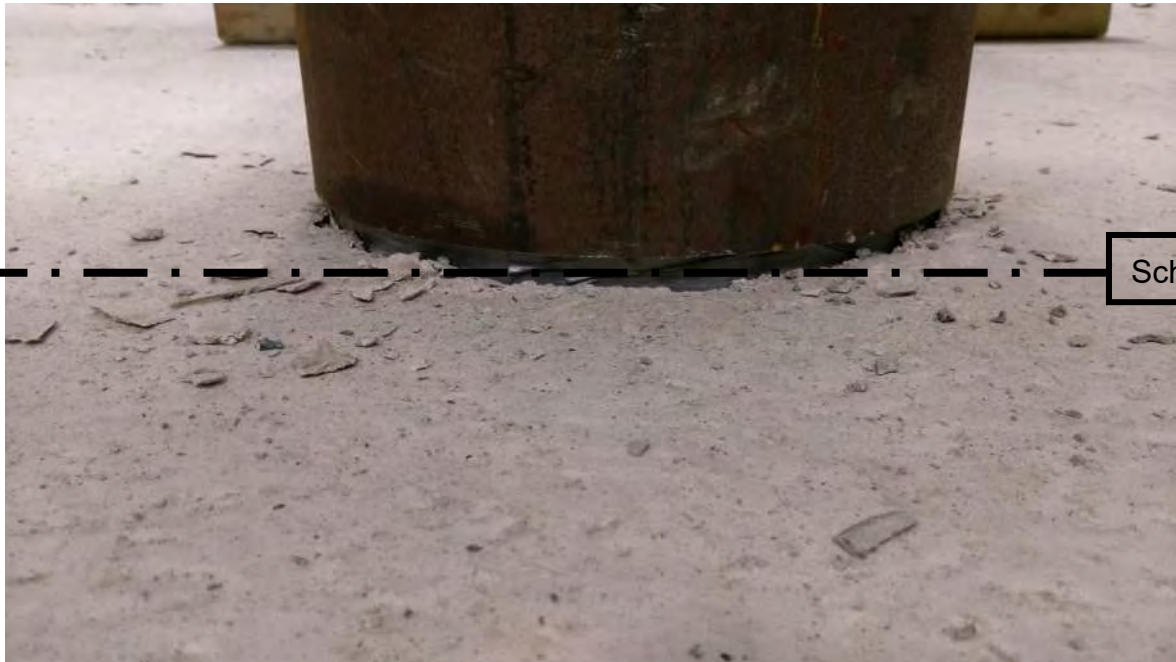
Rissverlauf um Stütze
