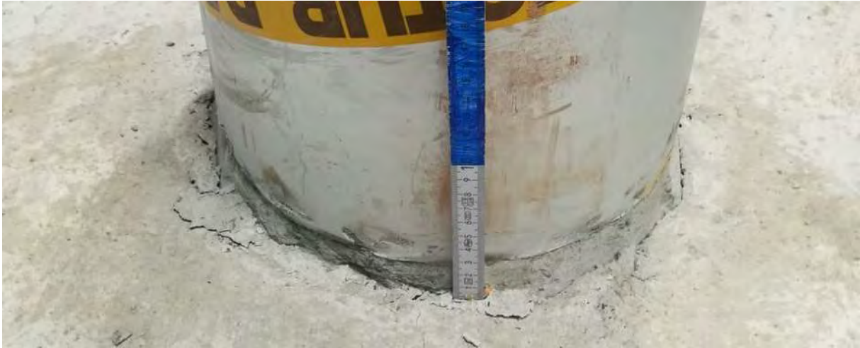
Rissverlauf um Stützeändern
