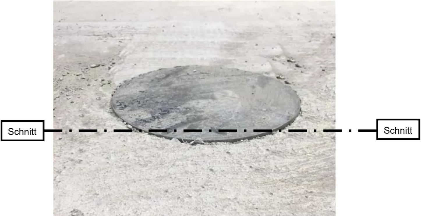
Rissverlauf um Stütze
