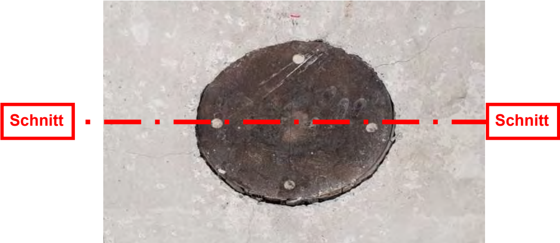
Rissverlauf um Stütze
