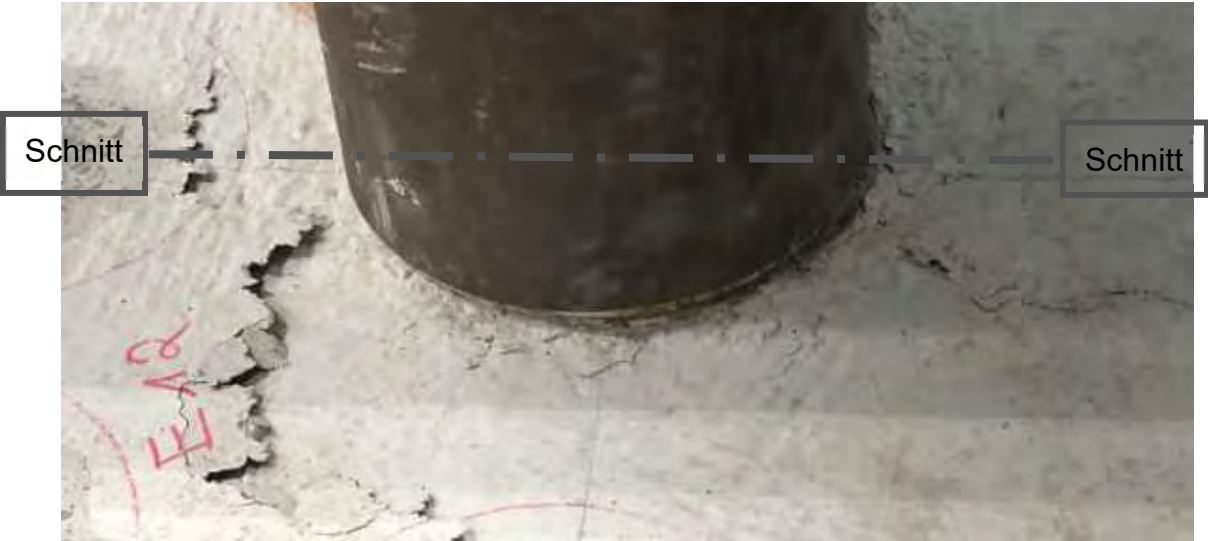
Rissverlauf um Stütze
