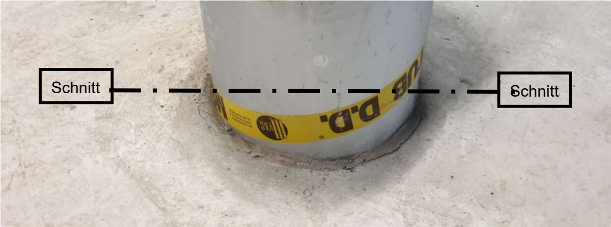
Rissverlauf um Stütze
