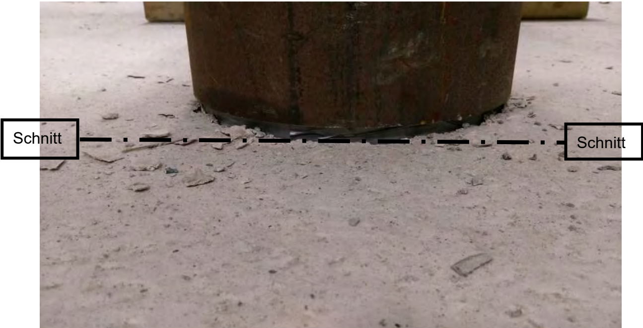
Rissverlauf um Stütze
