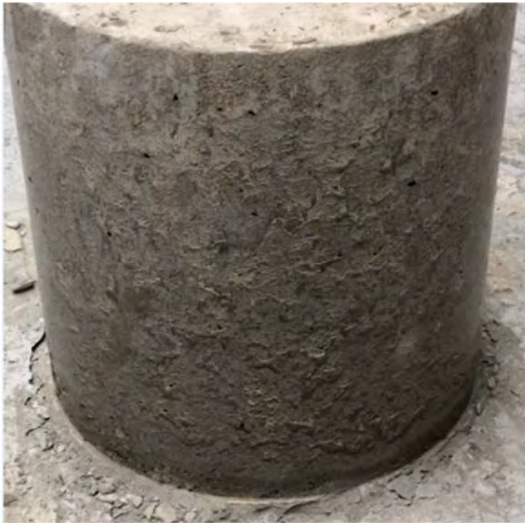
Rissverlauf um Stütze
