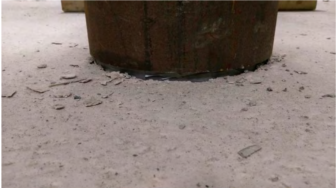
Rissverlauf um Stütze
