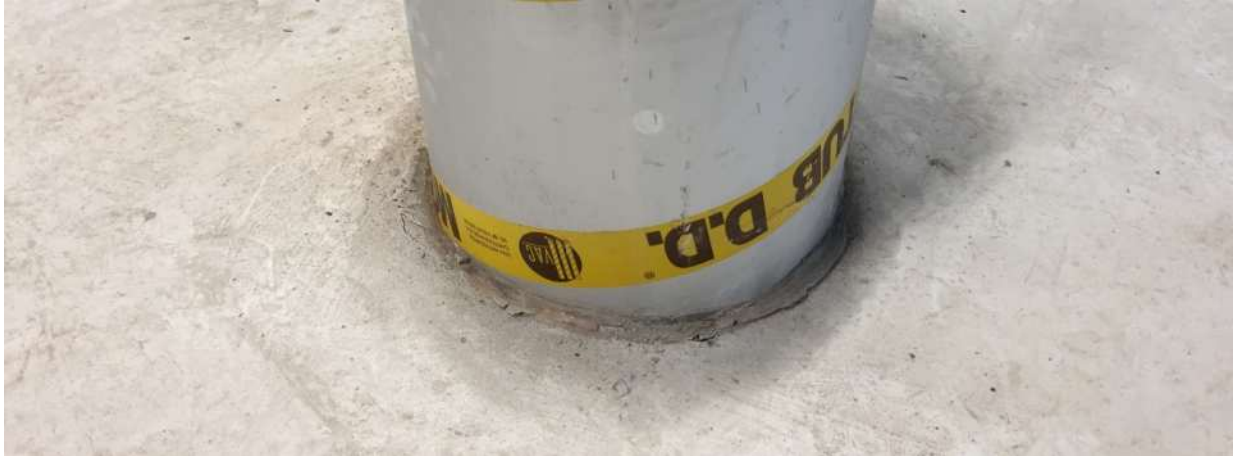
Rissverlauf um Stütze
