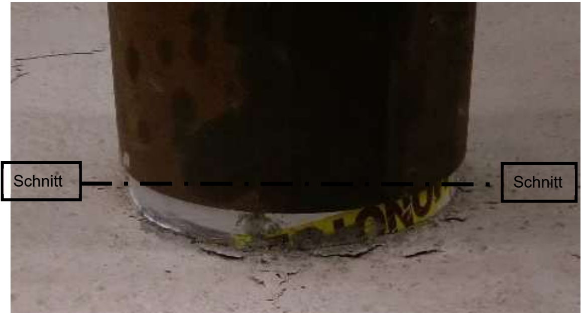
Rissverlauf um Stütze
