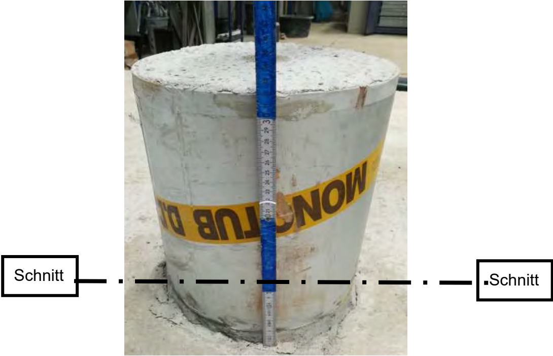
Rissverlauf um Stütze
