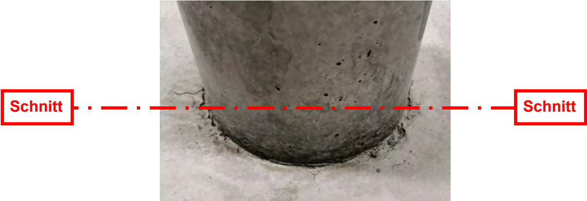
Rissverlauf um Stütze
