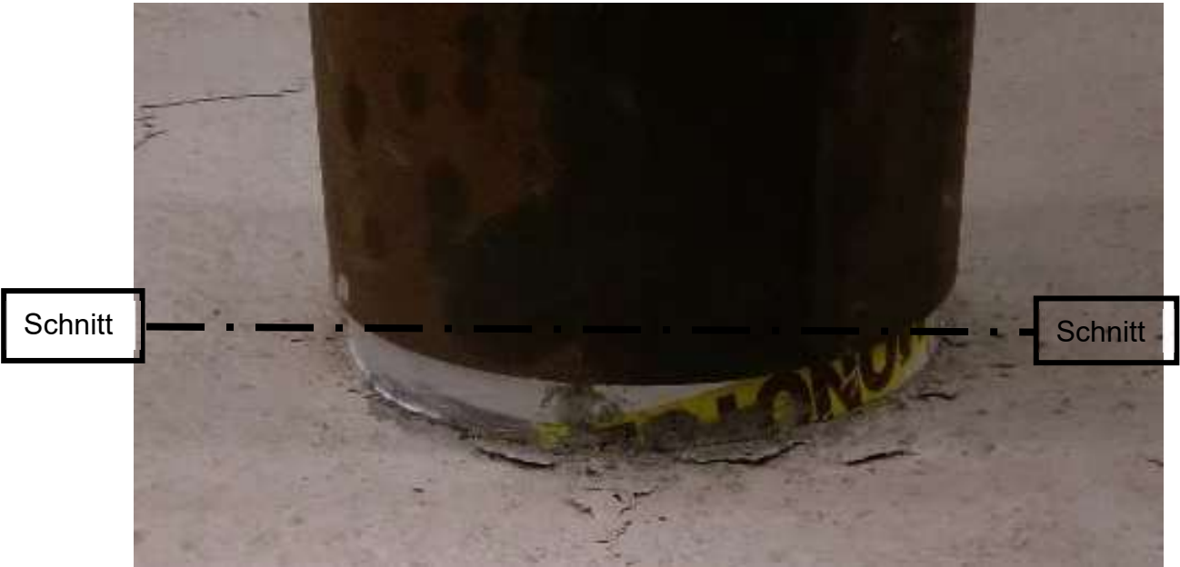
Rissverlauf um Stütze
