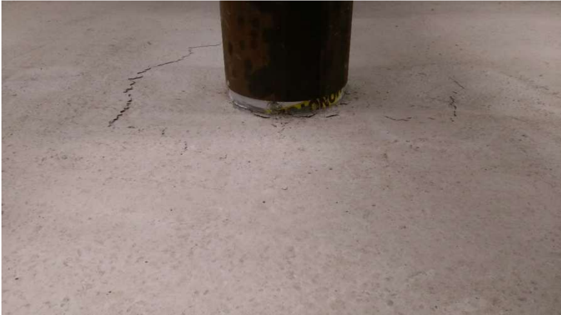
Rissverlauf um Stütze
