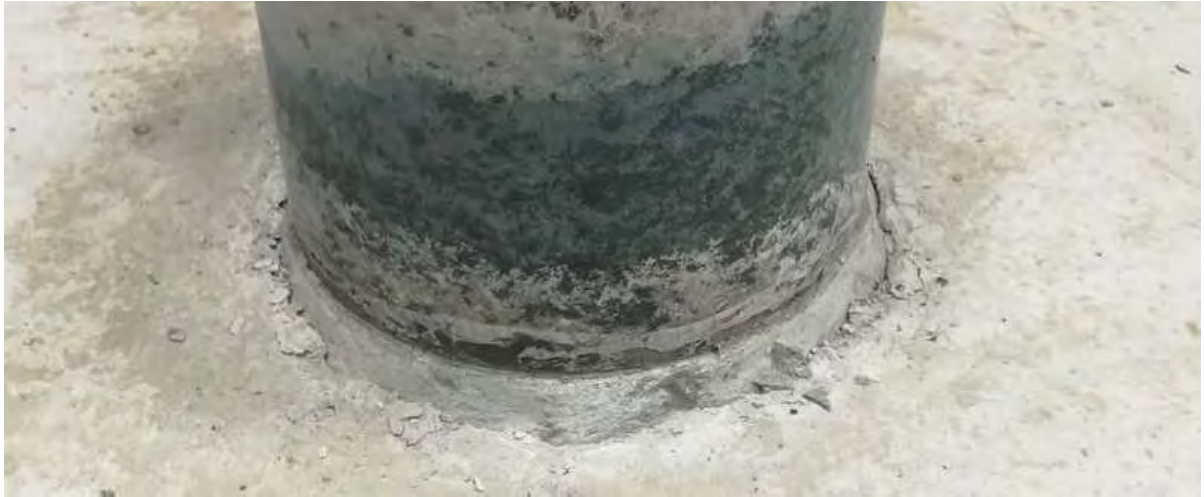
Rissverlauf um Stütze
