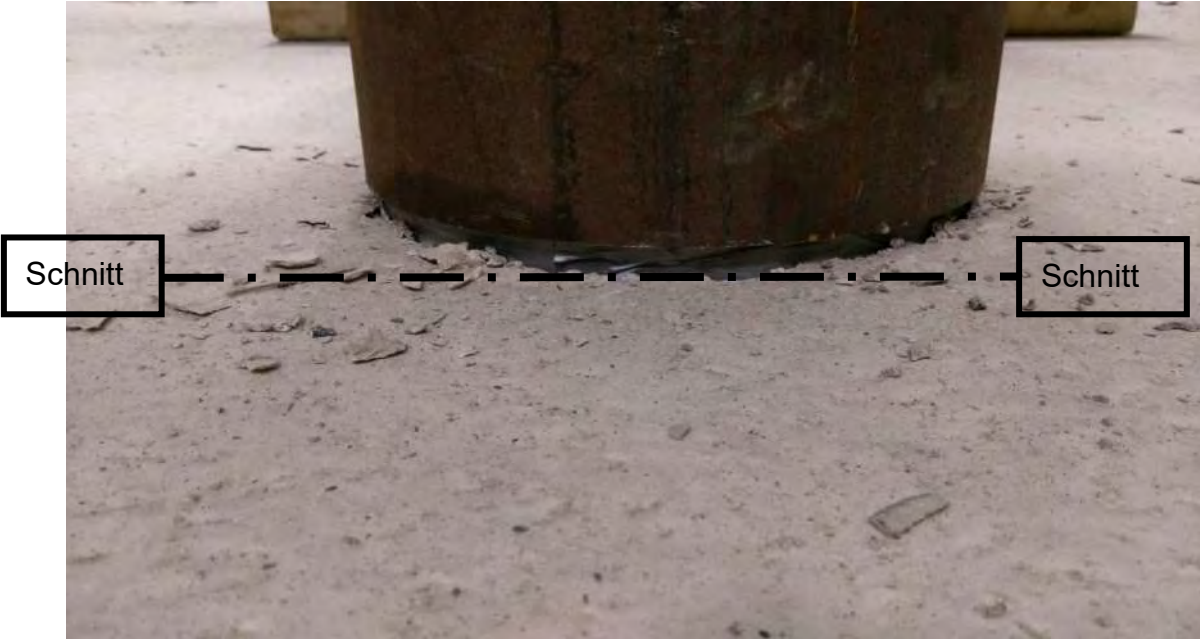
Rissverlauf um Stütze
