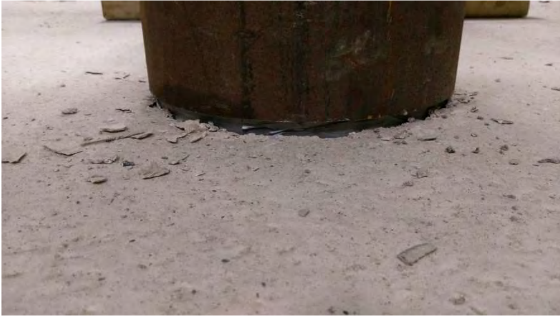
Rissverlauf um Stütze
