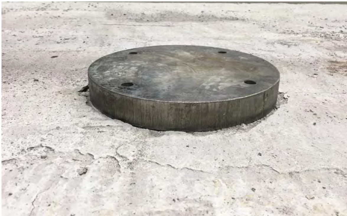
Stahlplatte als Stütze auf der Betonoberfläche - nach der Prüfung
