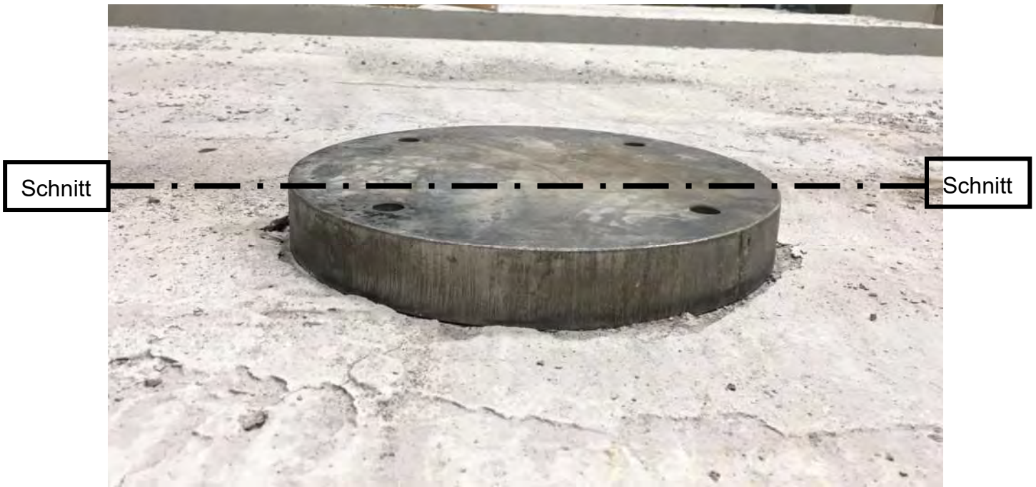
Rissverlauf um Stütze
