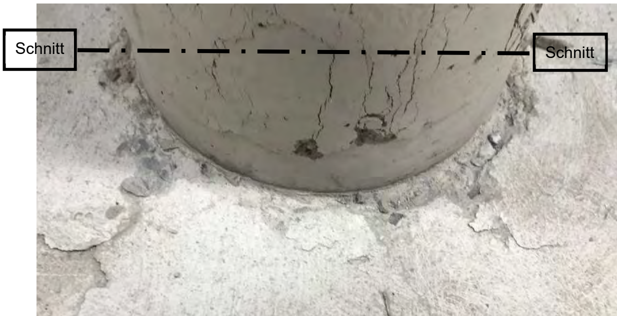
Rissverlauf um Stütze
