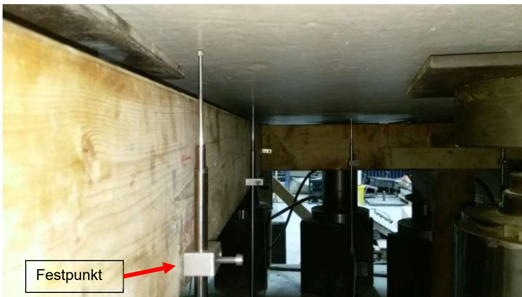
Wegaufnehmer im eingebauten Zustand
