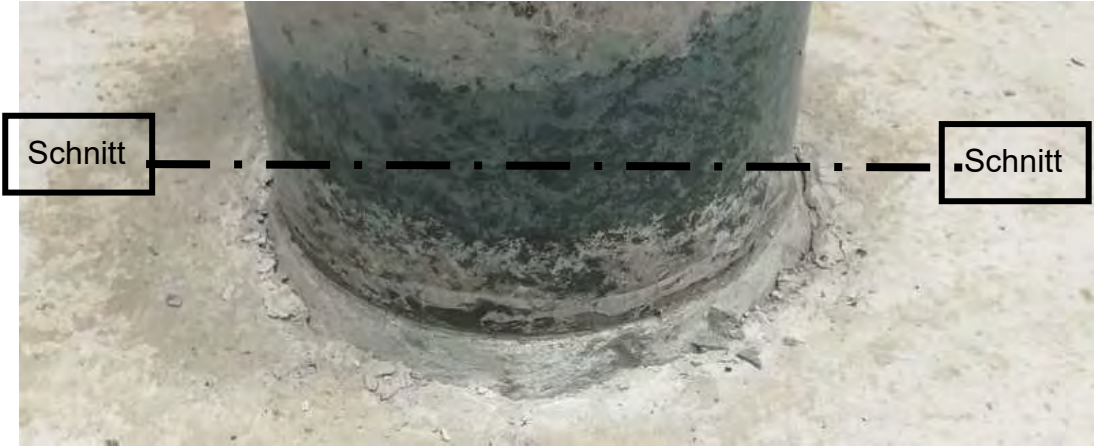
Rissverlauf um Stütze
