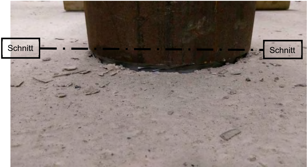
Rissverlauf um Stütze
