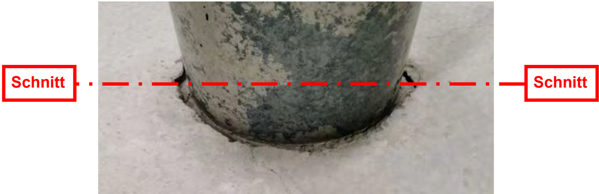
Rissverlauf um Stütze
