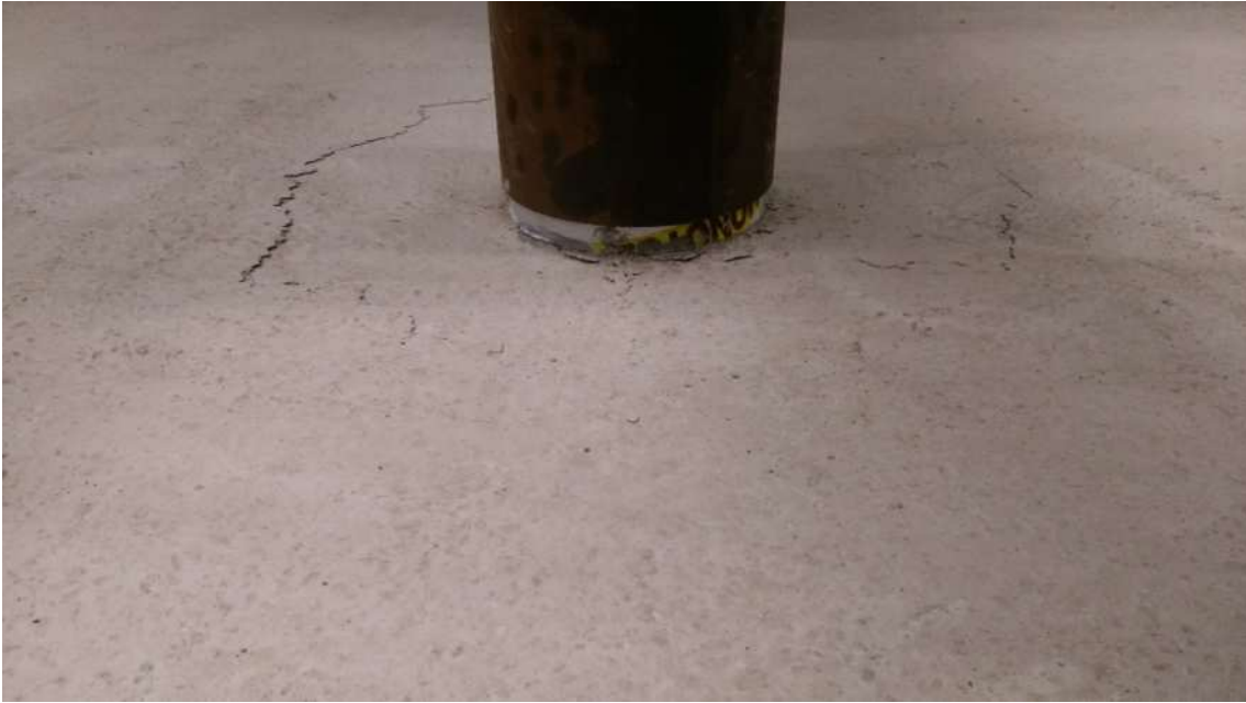
Rissverlauf um Stütze
