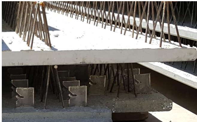
Bild 9 Lagerung von Halbfertigteildecken mit fertig einbetonierten L-Blechen ohne Stapelhilfen
