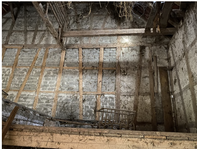
Abbildung 4.1: Außenwand der Scheune des Bauobjekts mit sichtbarem, konstruktivem Fachwerk. Die unteren Gefache sind mit Mauerwerk aufgefüllt, die Giebelgefache mit Kalkbruchstein und darüber aufgetragenem Lehmputz.
