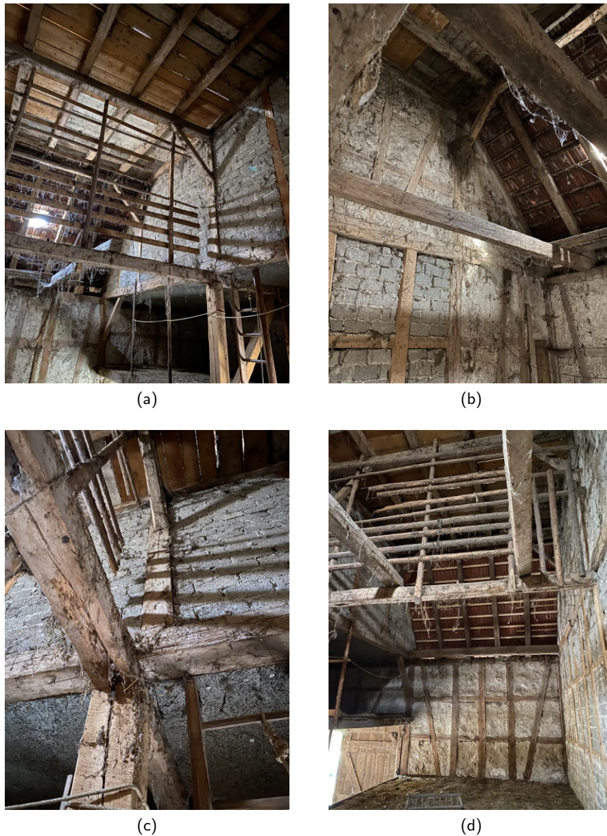
Abbildung 4.8: a Blick vom Heulager in die Scheune. b Fachwerk-Außenwand und Balken. c Mauerwerk und Balken. d Heulager und Fachwerk-Außenwand.
